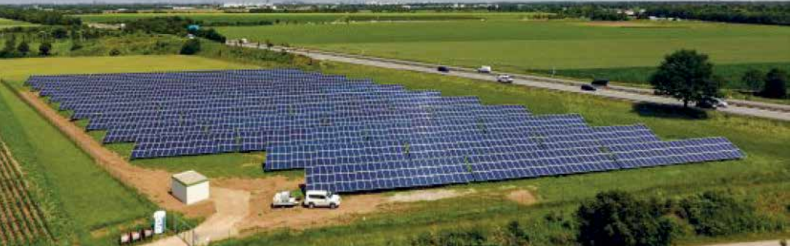
BEU PV-Freiflächenanlage an der A8. Foto: BEU
