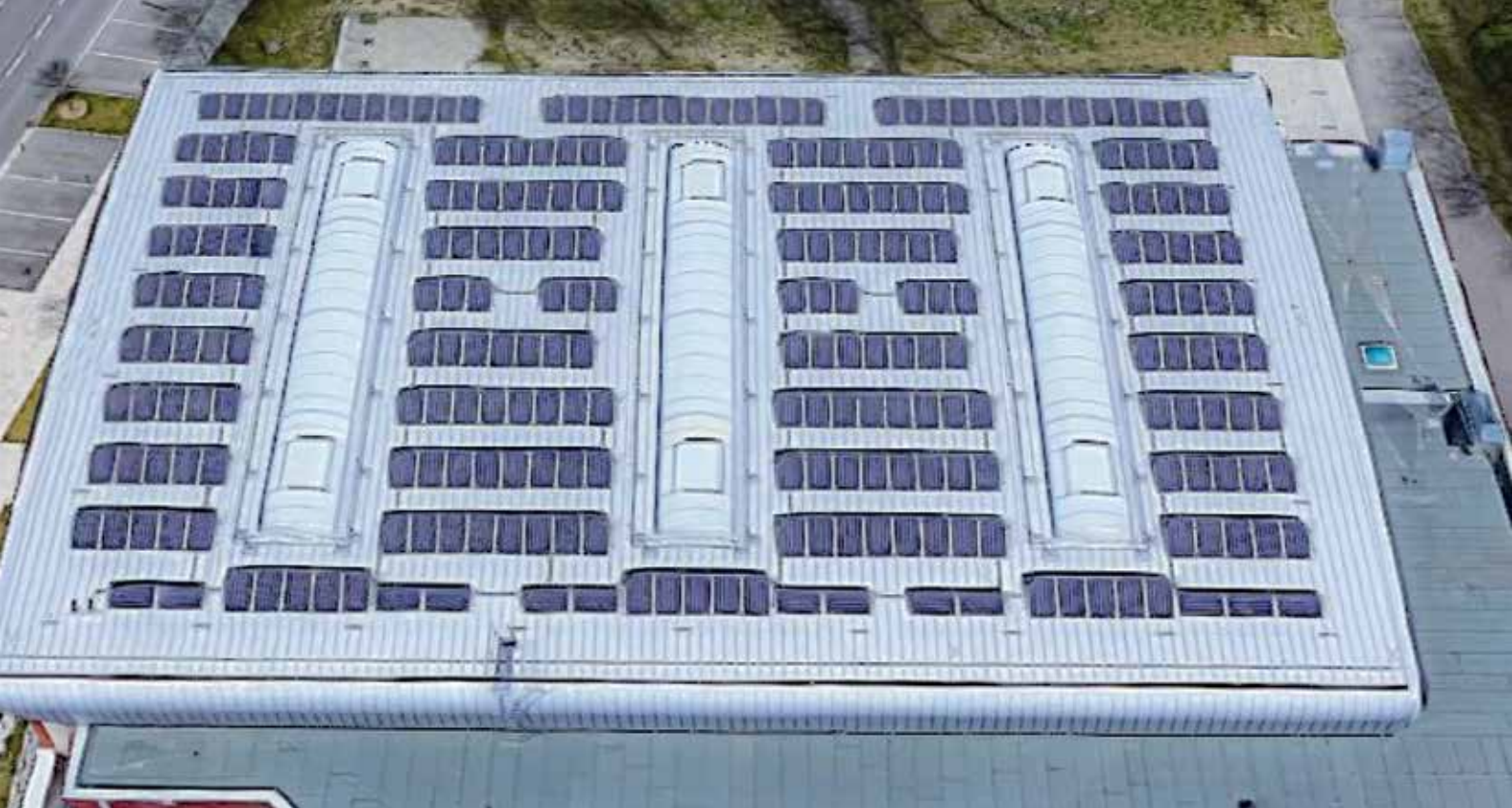
BEU Photovoltaik Dachanlage auf der Ferdinand-Leiß-Halle in Ottobrunn. Foto: BEU
