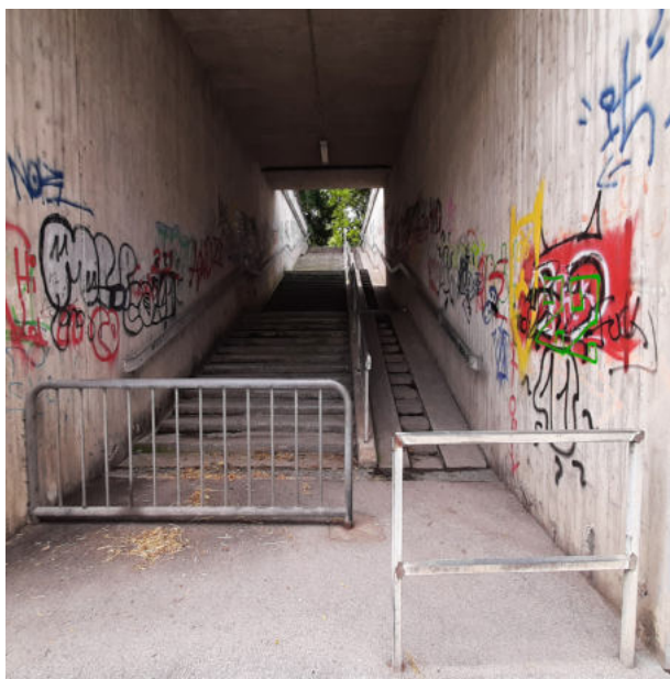
Abbildung 20: Beispiel Schwächen: Umlaufsperrn in der Aschheimer Straße
